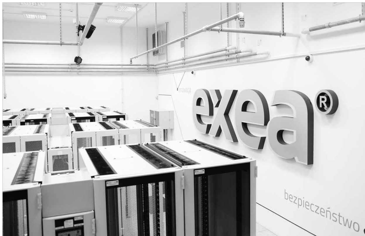
W Toruńskim Parku Technologicznym działa Hub Innowacji Cyfrowych. Jego częścią jest Exea Data Center , zaprojektowane z myślą o rozwiązaniach chmurowych
